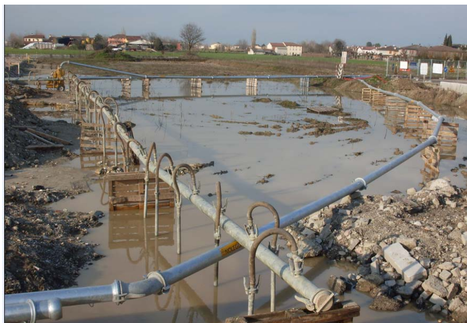
Fig.6 Sistema di scarico delle acque emunte
